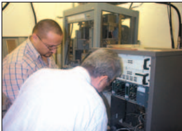
Detalj sa tehničkog pregleda
